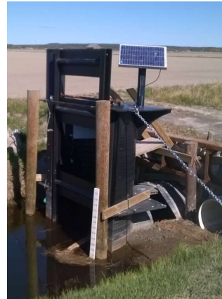
Dammen har en solenergidriven elmotor.
